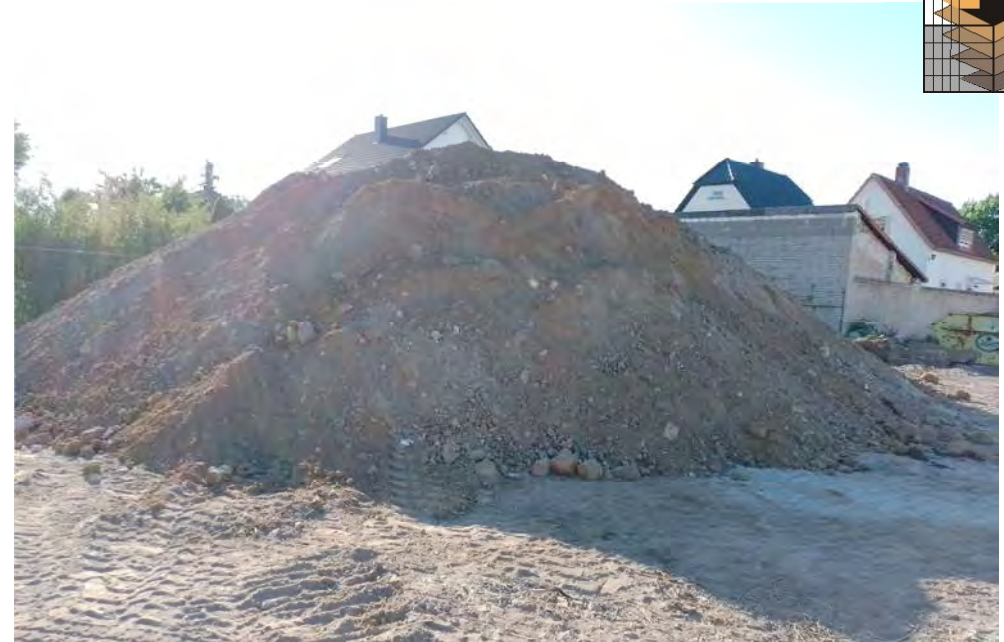
Aufgesetztes Haufwerk aus fremd- und störfstoffdurchsetzten Auffüllungen.
