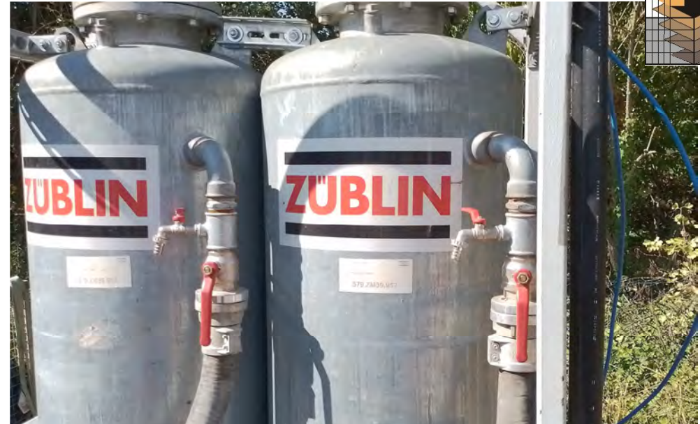
Wasseraktivkohleeinheiten mit Probenahmestellen für das gereinigte Wasser im Ablauf.
