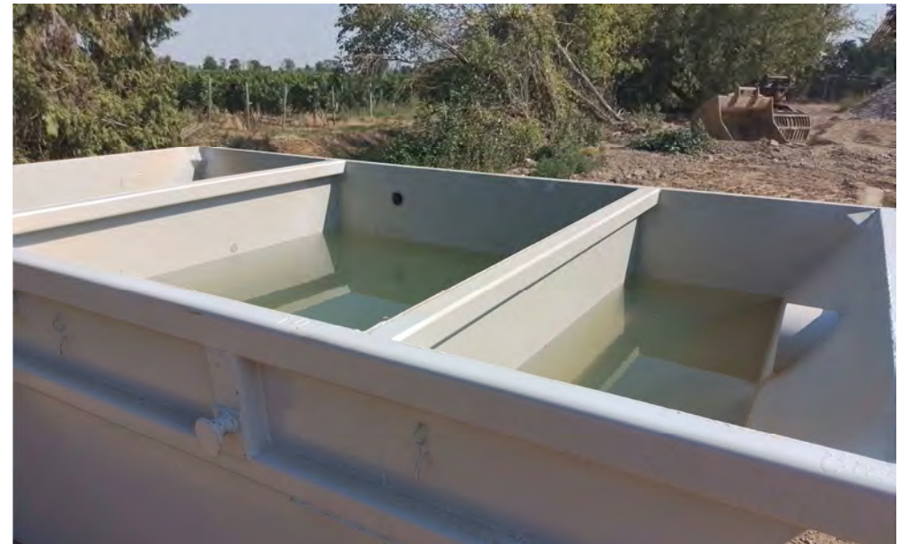
Gekammertes Vorhaltebecken zur Sedimentation der Schwebfracht vor Einleitung in den Stechgraben.
