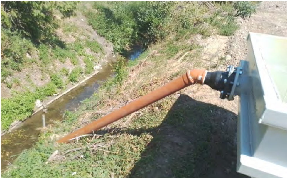
Ablauf des gereinigten Grundwassers aus zweitem Sedimentationsbecken in den Stechgraben.
